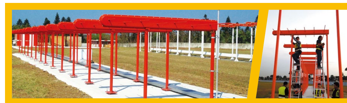
馬公機場及高雄機場 ILS 設備 ILS in Magong Airport and Kaohsiung International Airport
